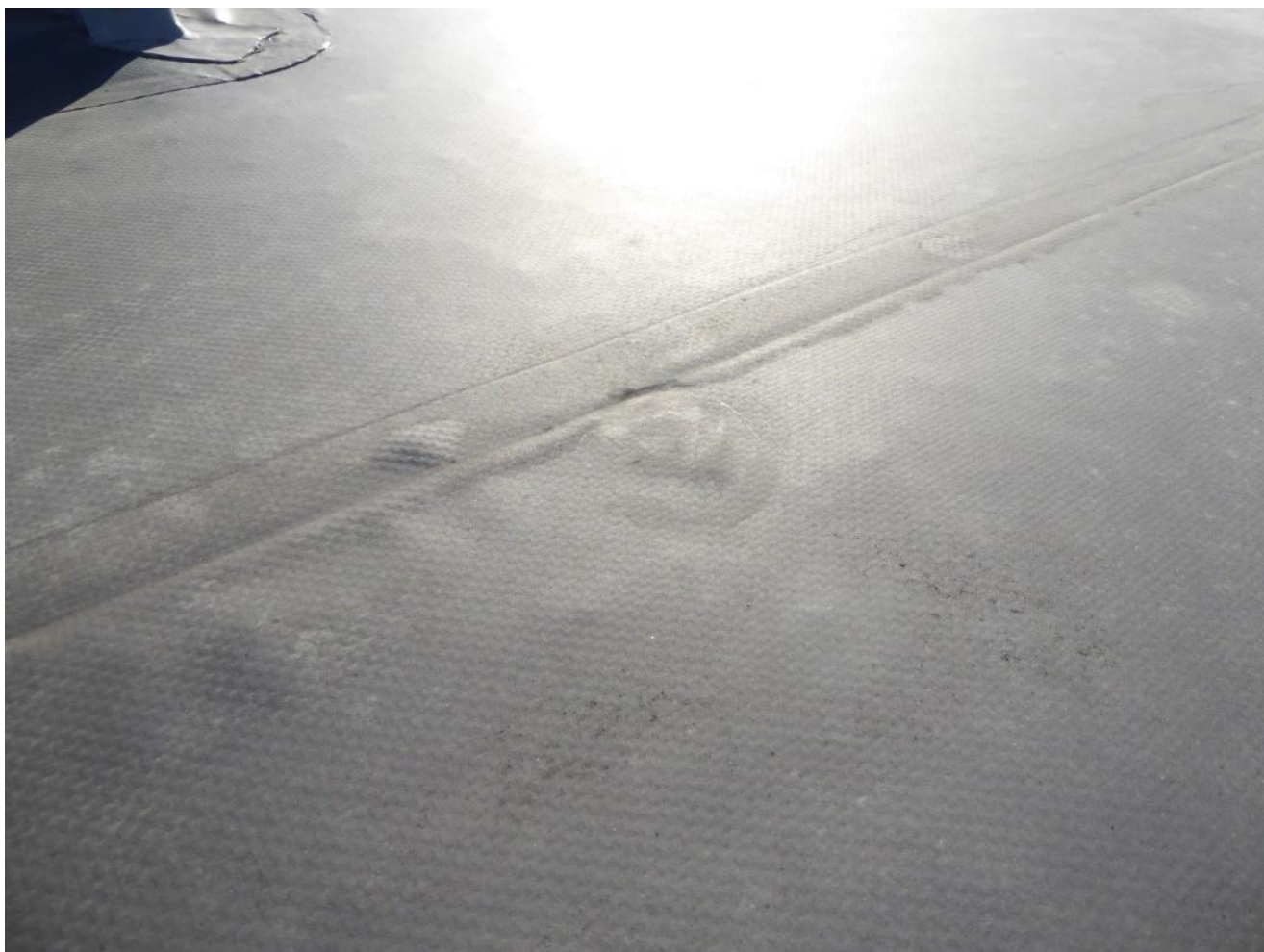
Bobler i skjøt.
