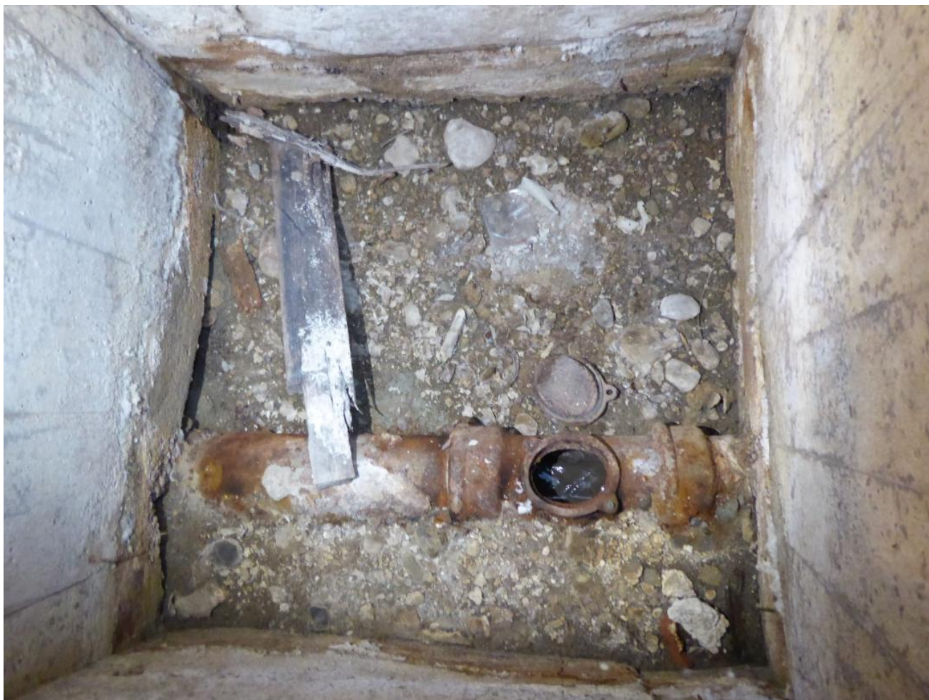
Avløpsrør i stakemkum. Manglende lokk. Ingen rotter observert på befarings.
