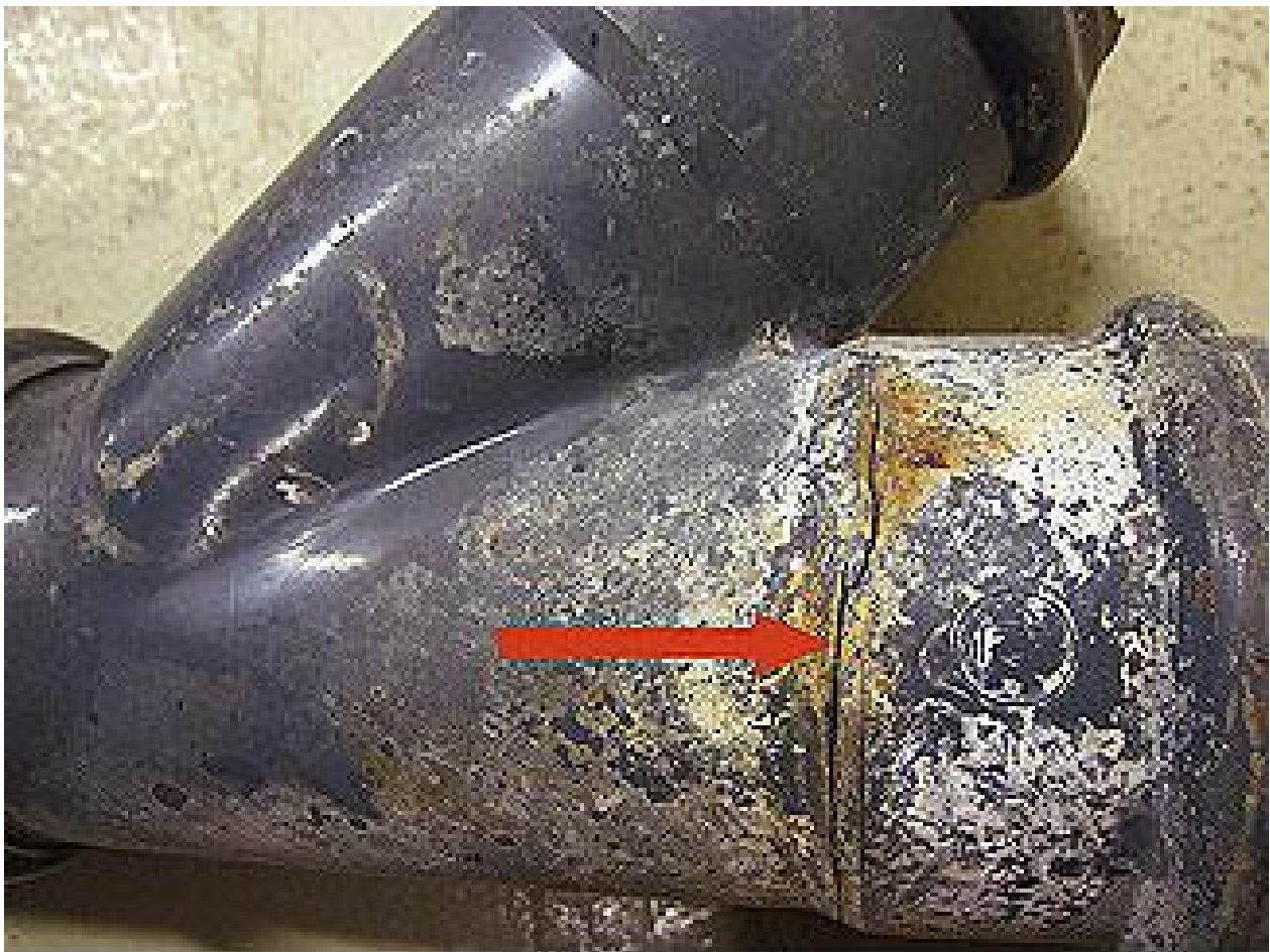
Illustrasjonsbilde brudd på avløpsrør.
