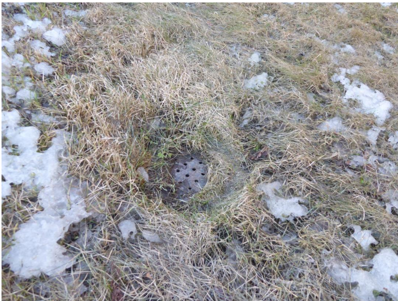
Sluk for drenering av vann mellom blokkene.
