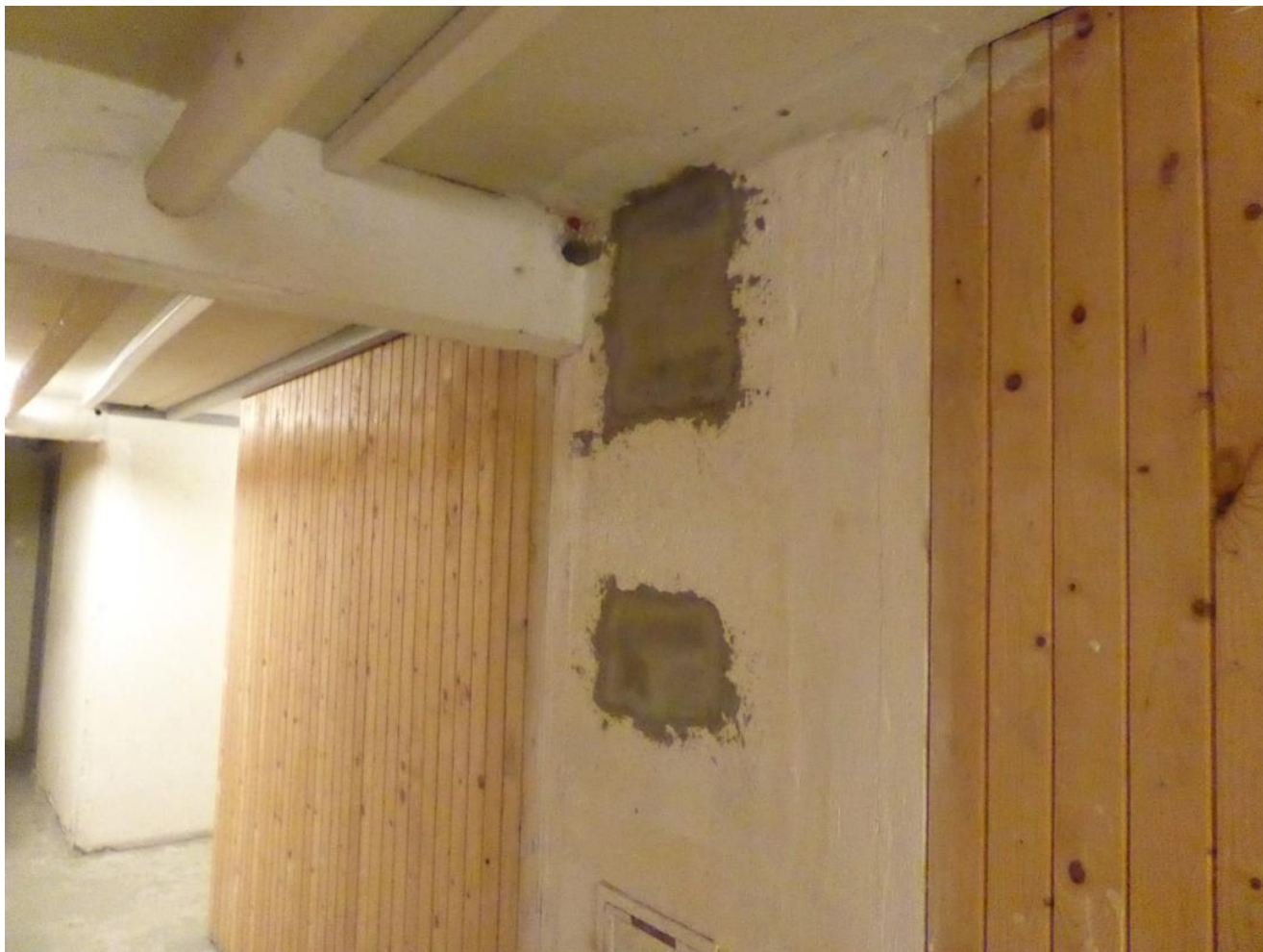
Tidligere gjennomføringer tettet.
