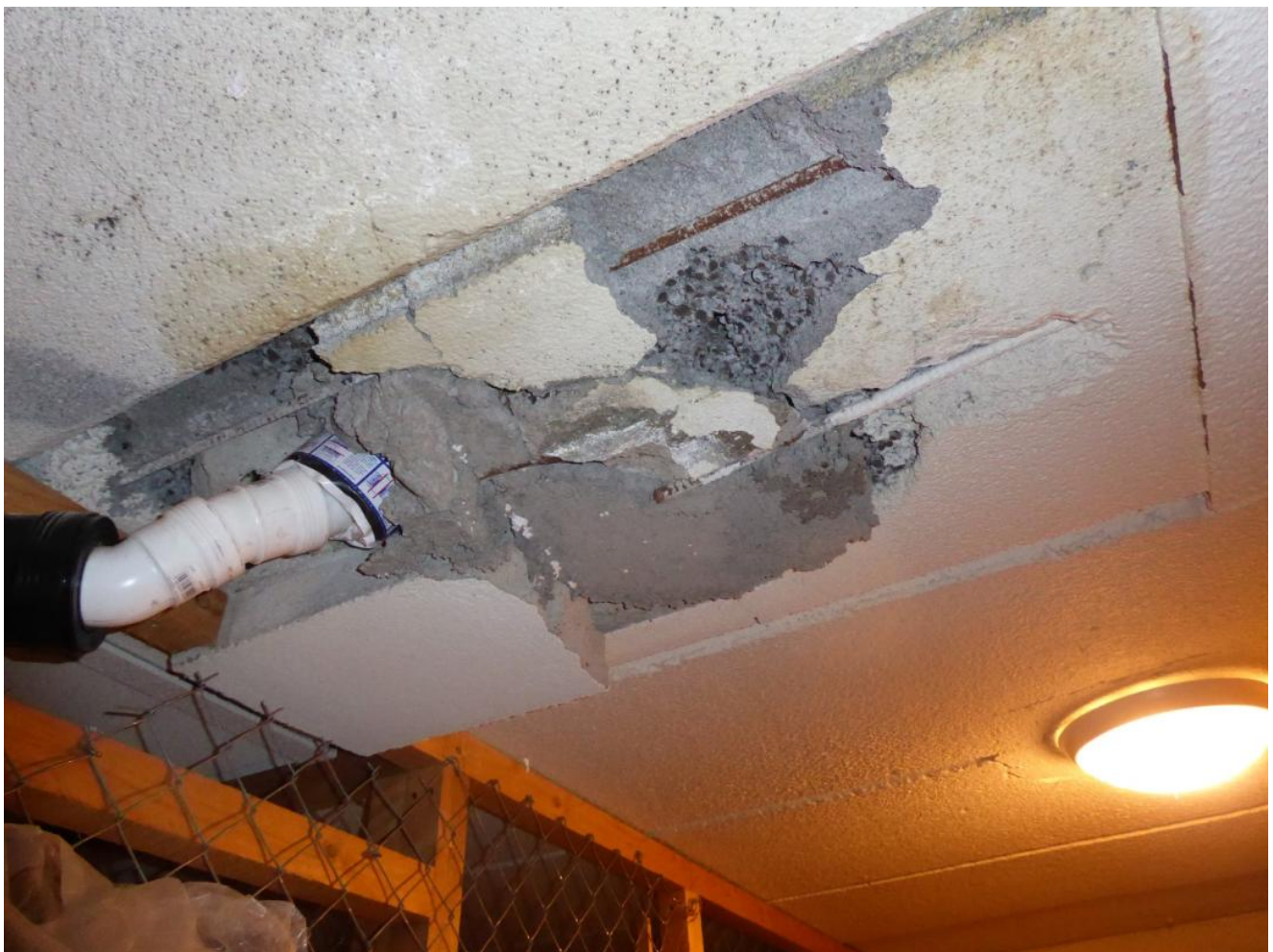
Synlig armering etter slukskifte.
